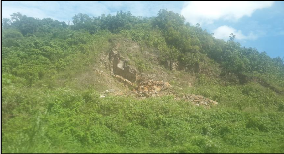
Gambar 1.4 : Kawasan tanah runtuh di sekitar jalan
