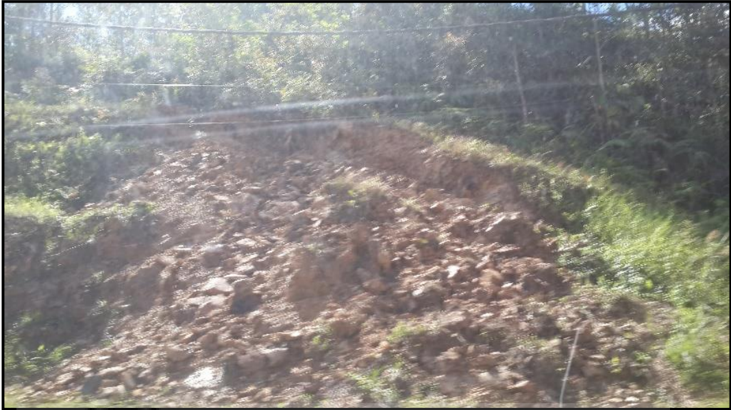
Gambar 1.2 : Kawasan Kejadian Tanah Runtuh di Kawasan Kajian Sumber : Woon (2017)
